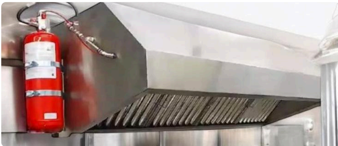
Sistema PROTEX instalado en campana mural
